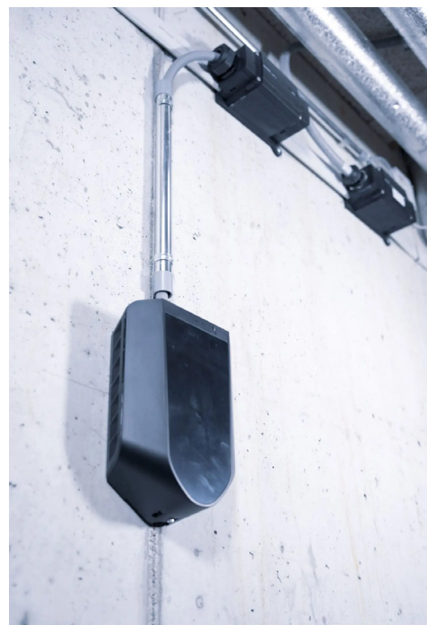
Ladestasjon med strømforsyningsboks og mateboks
