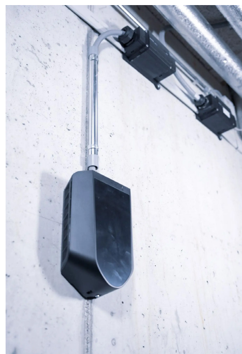
Ladestasjon med strømforsyningsboks og mateboks
