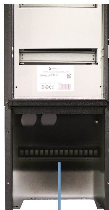
Kabelfeste i sokkel
