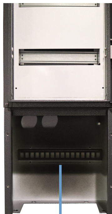
Kabelfeste i sokkel
